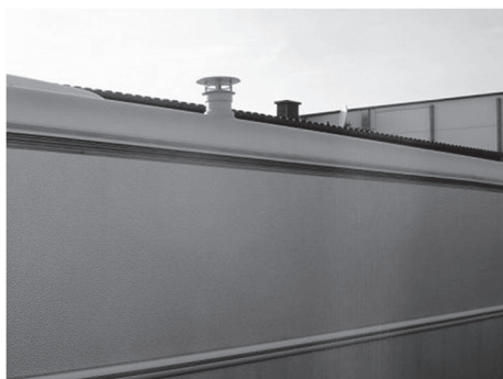
Abb. 84: Abgaskamin der Gasheizung
